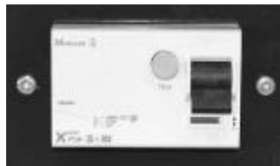
Interruptor 40 A curva D Diferencial 30 mA
